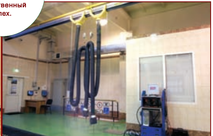
Автомобиль может газовать в помещении сколько угодно. Система удаления отработавших газов сохранит воздух чистым.
